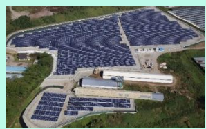
デンケン太陽光20MW (主電源)
